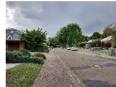
Straße mit Mängeln
